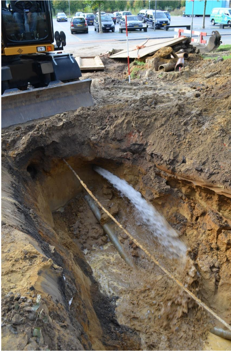
Afbeelding 23: Graafwerkzaamheden aan de voet van de Kerkstraat. Op de achtergrond is de parkeerplaats van Don Bosco zichtbaar. De waterleiding is net geraakt en het water stroomt in de put.
